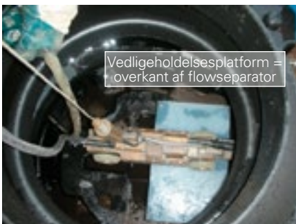
Kontrol af spuleresultat med panorerende kamera, kamera på vedligeholdelseskonsollen i startsegmentet til et SediPipe-anlæg
