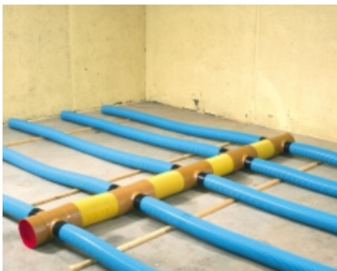
Anlæg hvor hovedkanalen består af kryds, anvendes hvor bredden på rummet er mere end 8-10 meter, eller hvis placeringen af blæseren taler herfor
