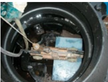
Kontrol af spuleresultat med panorerende kamera, kamera på vedligeholdelseskonsol i indløbsbrønden til et SediPipe L anlæg
